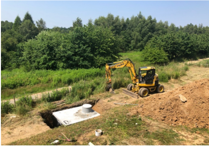
Zbiornik podziemny na wody opadowe przy domu jednorodzinnym, gmina Zabierzów (fot. Renata Bogdańska-Warmuz)
